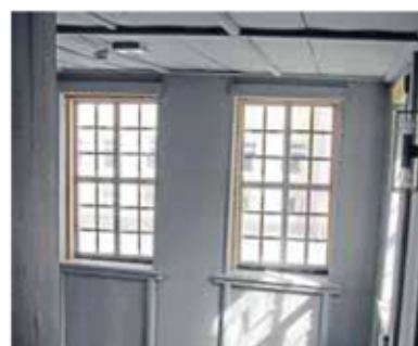
Gerade Fenster in schiefer Wand: Der „Tunnelblick“ zeigt, wie schwer sich oft Substanzerhalt und Optik unter einem Hut bringen lassen. Foto: Herde
