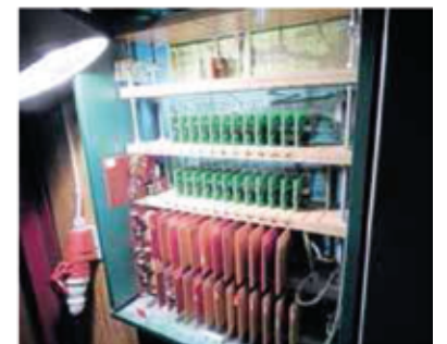
Relais für die Register. Die Elektrik ist marode und im Wortsinn brandgefährlich.
